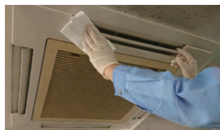
吹出し口やルーバー
